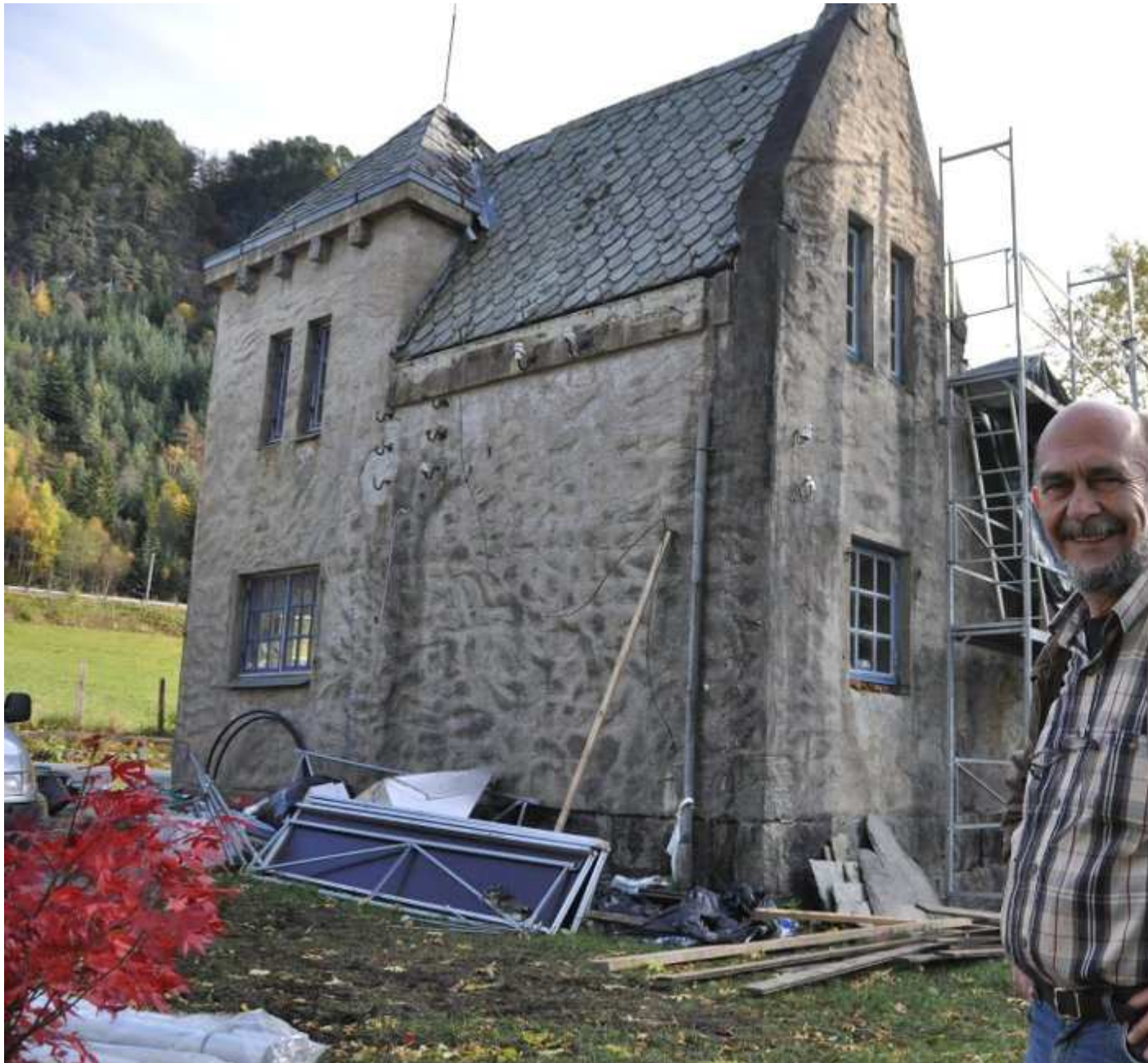
Reidar Handeland tykkjer det er bra at fylkeskommunen løyver pengar til å restaurera den gamle kraftstasjonen. Foto: Aasmund Taarn Sande
